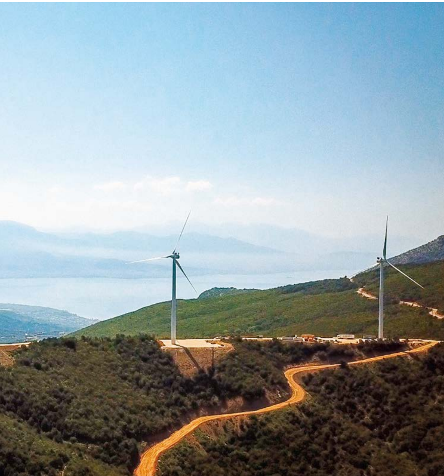
Α/Γ στη θέση Κουρομάντρι και στο βάθος Α/Γ στη θέση Ριγανόλακκα.
