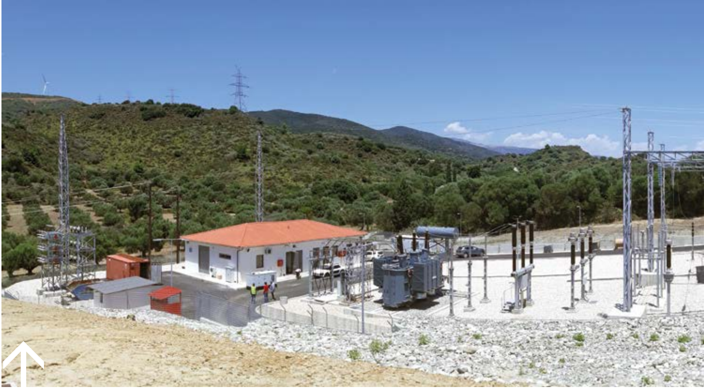
Υποσταθμός στη θέση Μολύκρειο
