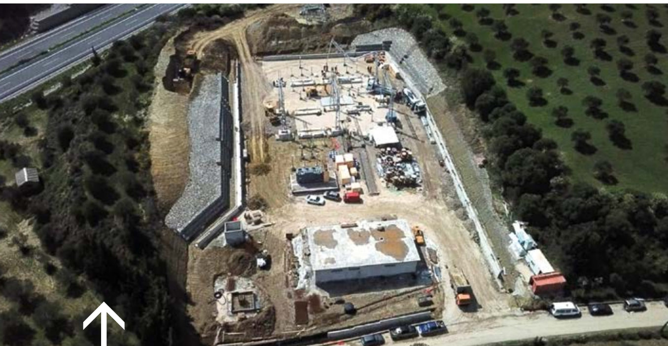
Εναέρια άποψη του Υποσταθμού
