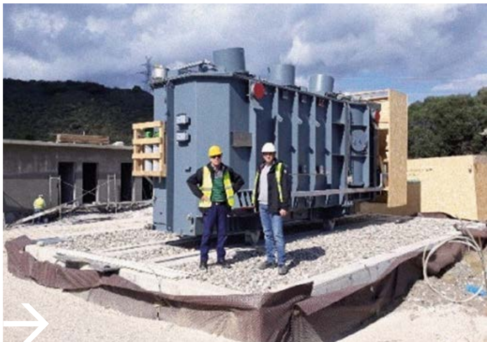
Μετασχηματιστής Μ/Σ 40/50ΜVA
